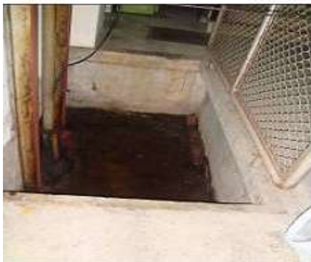
地下室之升降梯孔積水
