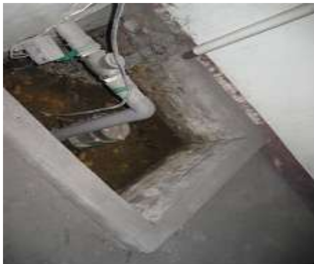
地下室儲水槽
